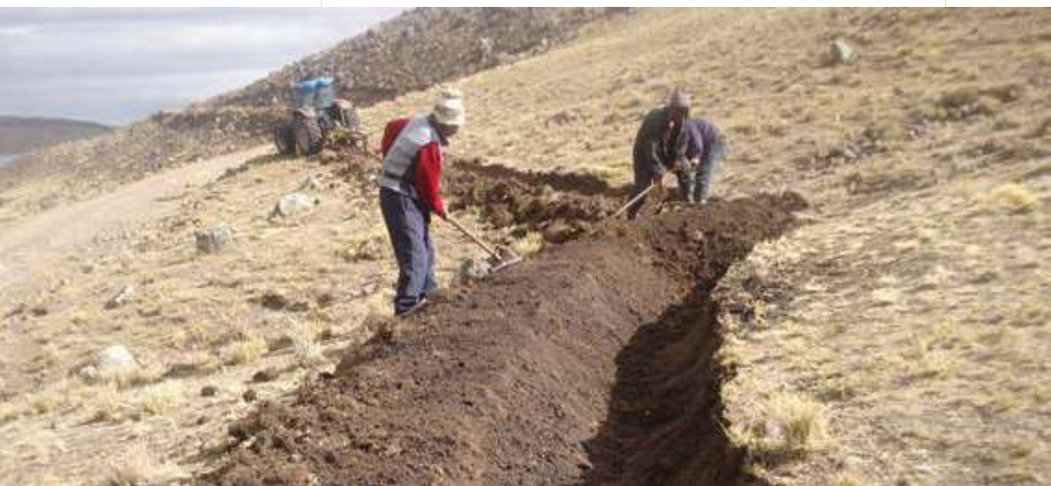
Figura 13. Construcción de zanjas de infiltración con maquinaria agrícola. Comunidad de Santa Inés, Distrito de Huancavelica, región Huancavelica. Proyecto Praderas GORE (Gobierno Regional) Huancavelica (Perú), 2013.
