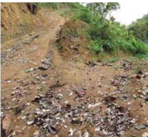
Figura 7. Talud en camino vecinal que necesita de prácticas de restauración vegetal y ser dedicado a la protección.
